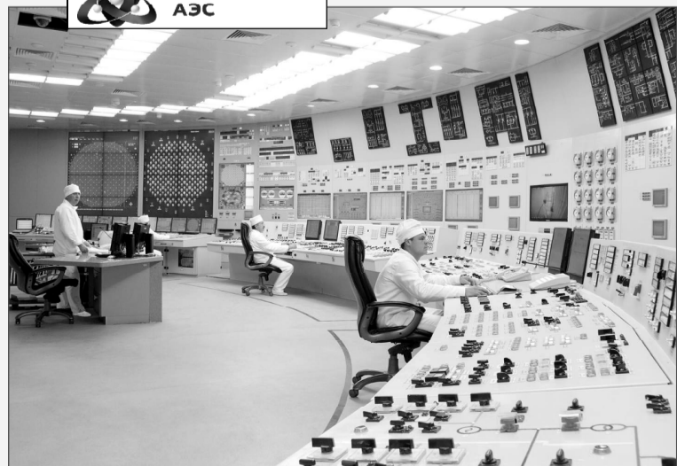
На снимке: блочный щит управления.
